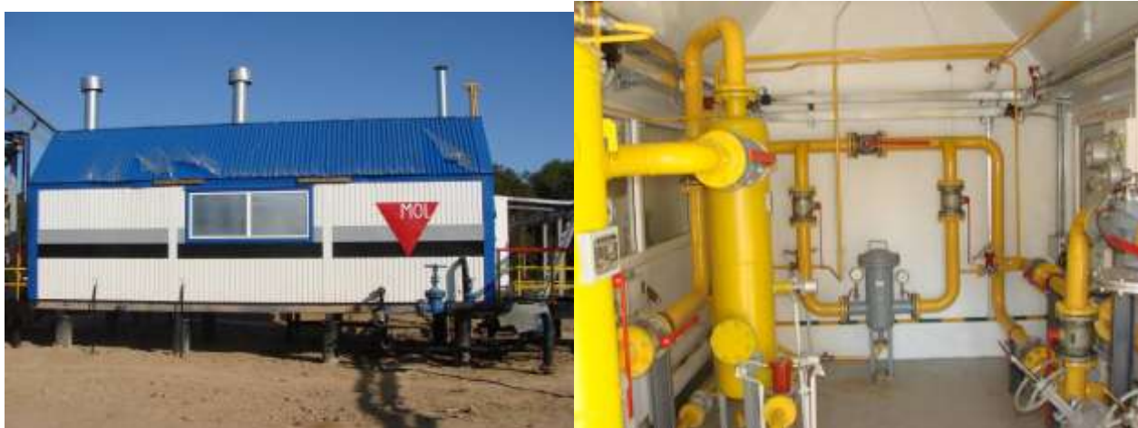
Рисунок 7 – Блок подготовки топливного газа для энергогородка Северо-Ледового месторождения
