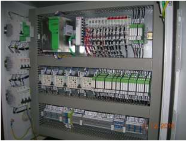
Рисунок 8 - Шкаф автоматики блочной установки для ГРС-1 Владивосток вид изнутри
